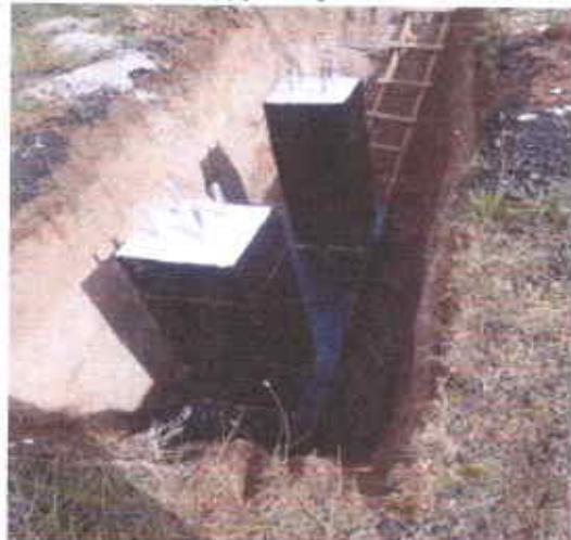
Бетон гадаргууд хар тосон түрхлэг түрхсэн байгаа нь
